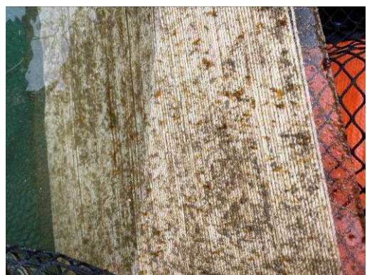
図10 浮泥による脱落
