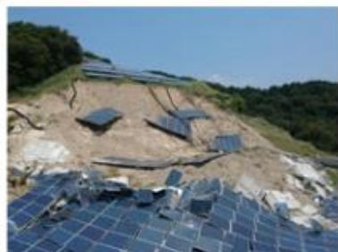
土砂崩れで生じた崩落
