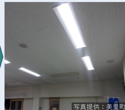
<蓄電池使用時>
