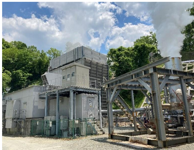
隣地にて稼働中の地熱発電所1号機
