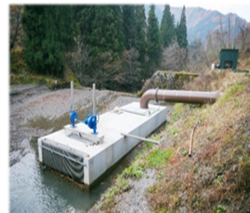
小水力発電施設
