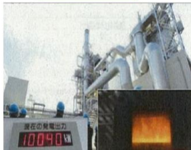
稼働中の木質バイオマス発電施設
