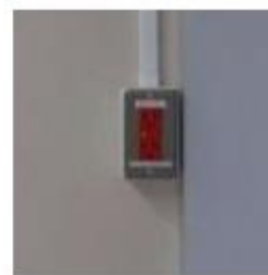
災害用コンセント
