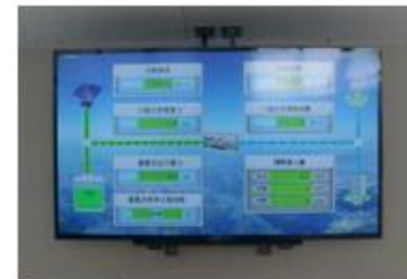
発電情報モニターの設置
