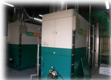
木質チップボイラ
