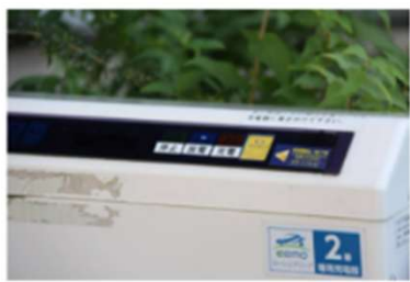
当日、EVから市庁舎へ放電している様子（その2）充放電設備の「放電」が点灯している。
