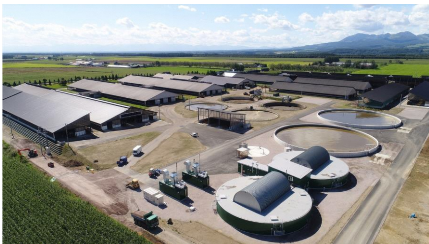
バイオガスプラント
