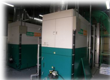
木質チップボイラ
