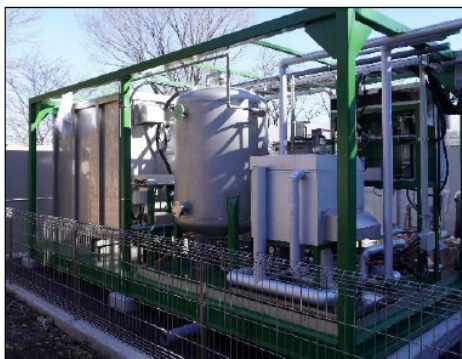
メタン発酵バイオガス発電設備
