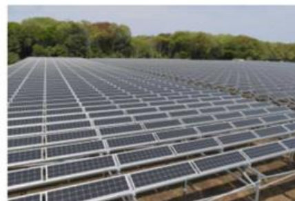
太陽光発電設備
