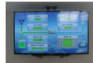
発電情報モニターの設置
