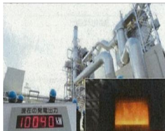
稼働中の木質バイオマス発電施設
