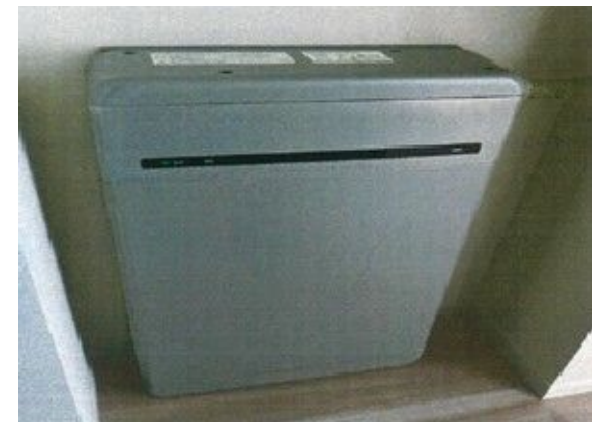
※蓄電池設置状況
