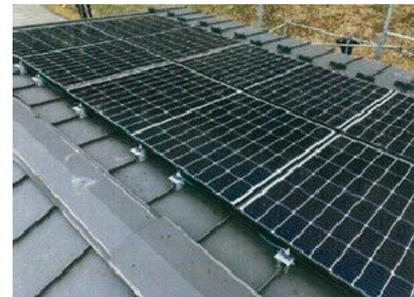
※太陽光発電設備設置状況
