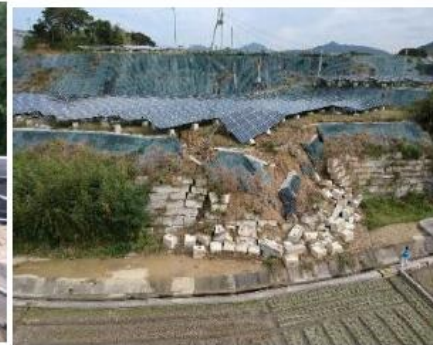
法面保護工が崩れて流出した事例
