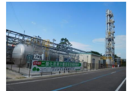
二酸化炭素分離回収設備
