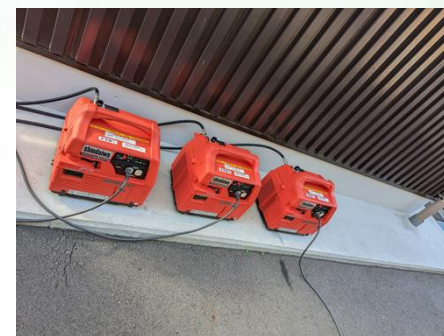
避難所におけるLPガス発電
