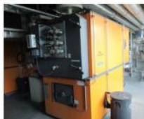
本庁舎の バイオマスボイラー
