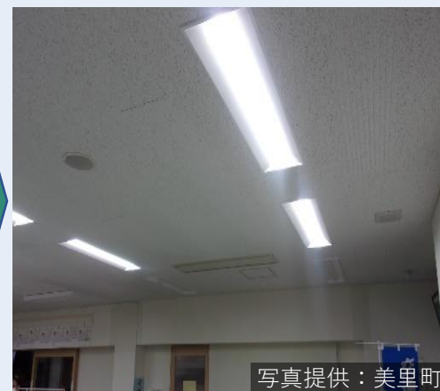
<蓄電池使用時>
