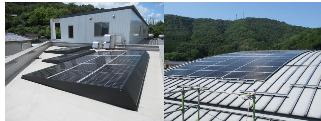
太陽光発電設備（PPA）
