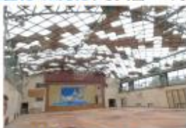
台風で屋根が消失した体育館
