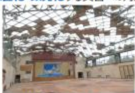
台風で屋根が消失した体育館
