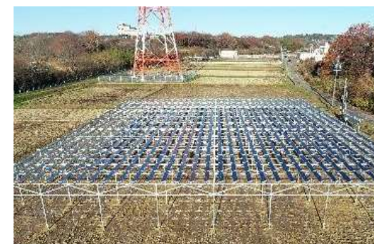
太啓建設(株) 浄水SS発電所
