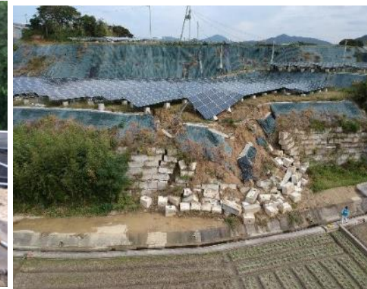
法面保護工が崩れて流出した事例
