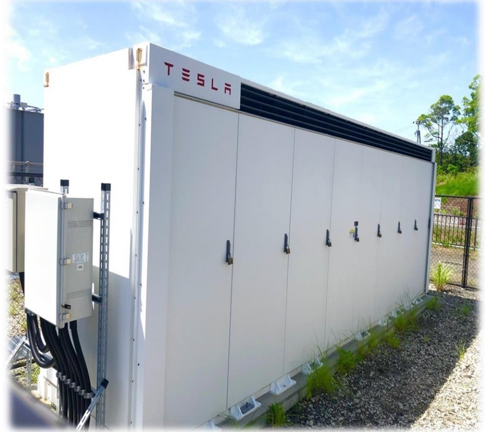
大容量蓄電池（1,100kwh）
