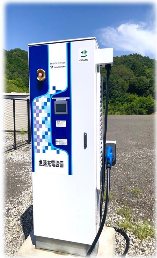
急速充電設備（50kw）
