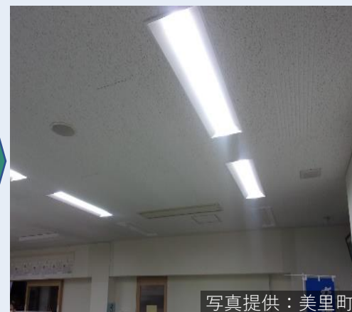
<蓄電池使用時>
