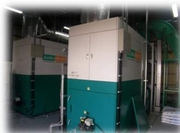
木質チップボイラ
