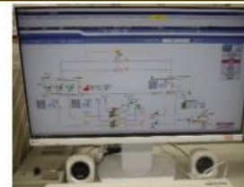
VWV制御 （空調機の冷温水流量を負荷に応じて調整）
