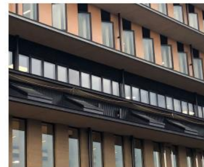
光ダクトシステムの採用
