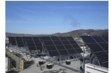
同時導入された太陽光発電設備
