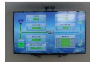
発電情報モニターの設置
