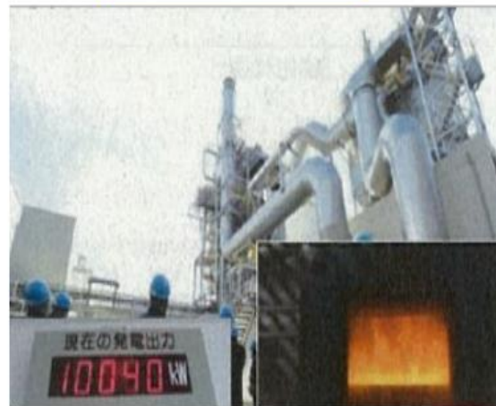
稼働中の木質バイオマス発電施設
