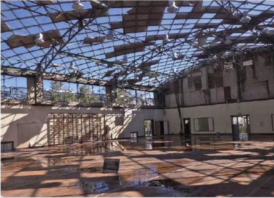
屋根が吹き飛んだ体育館
