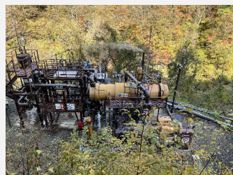
導入したバイナリー発電設備
