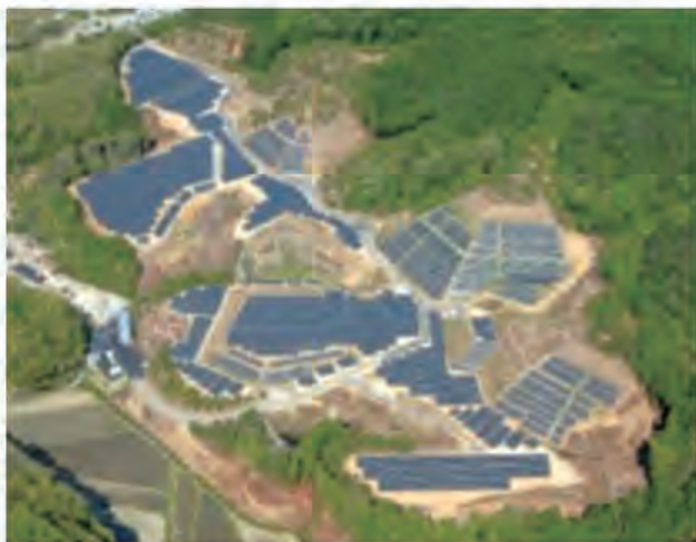
調達電源の京都・亀岡メガソーラー発電所
