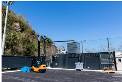
臼杵バイオマス発電所
