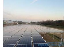
オフサイトPPAは合計2MW
