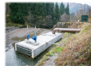
小水力発電施設
