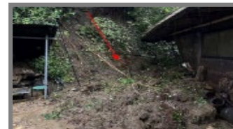
令和6年台風10号 宮崎県で発生したかけ崩れ (提供：国土交通省HP)
