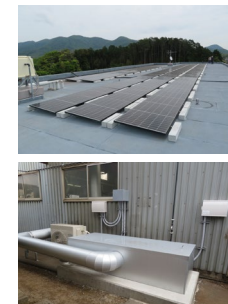
登録制度を活用し設置された太陽光発電設備や地中熱利用設備
