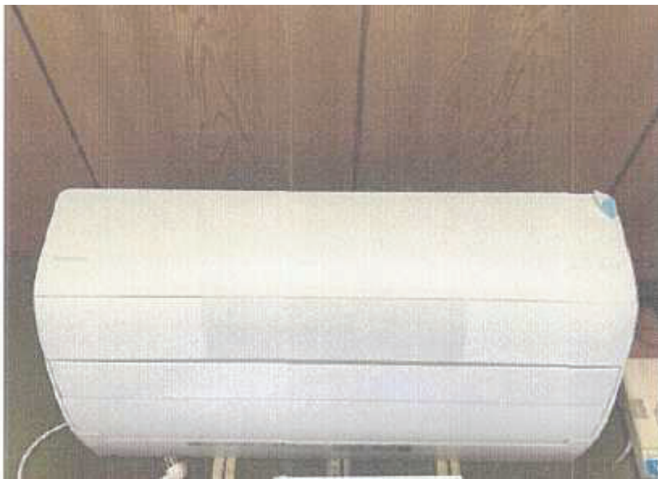
住民向け補助 省エネ設備設備(空調)
