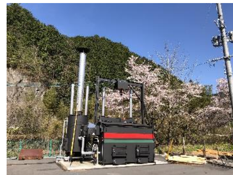
バイオマスボイラー
