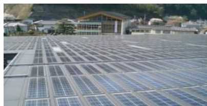
梼原町総合庁舎の太陽光発電 (既設)
