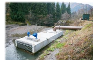
小水力発電施設
