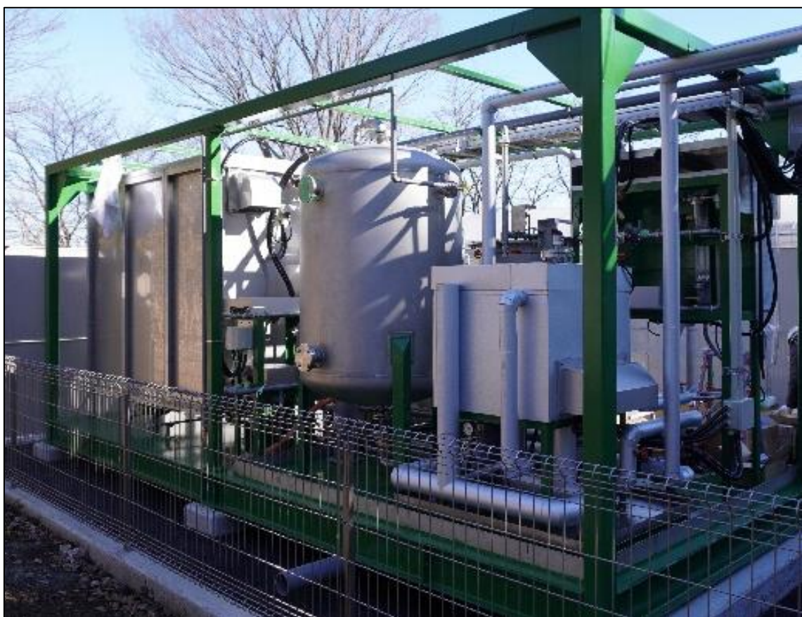
図10 メタン発酵バイオガス発電設備
