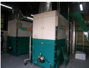
チップボイラー
