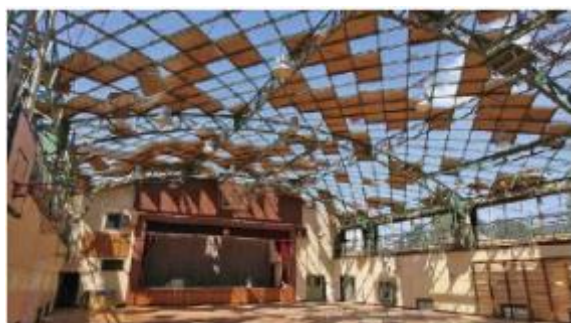
令和元年台風15号で破損した市立小学校の屋内運動場
