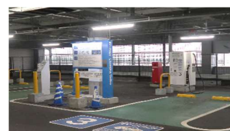
充電設備の整備
