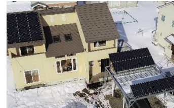
住宅用太陽光発電設備
