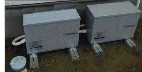
個人向け蓄電池設備
