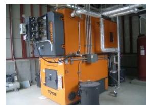
木質バイオマスボイラー
