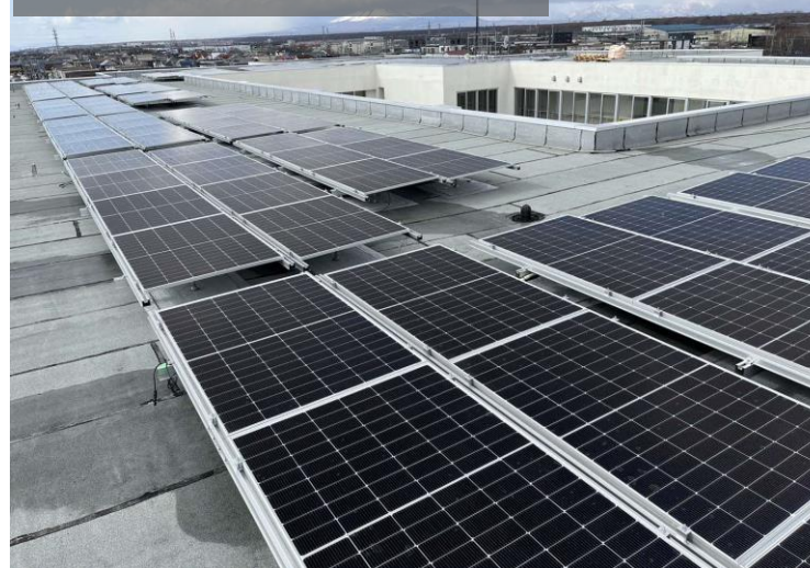
中学校への太陽光発電設備の導入
