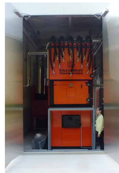
バイオマスボイラーの導入例
