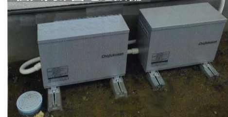
個人向け蓄電池設備
