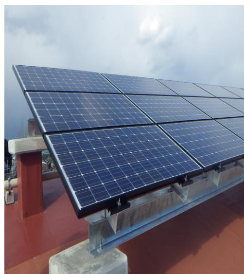
太陽光発電設備の導入例
