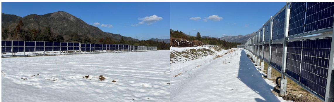
垂直型太陽光発電設備が太陽光の雪面反射により設備容量上限で発電している様子 (島根県邑南町)
