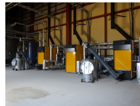
木質バイオマス熱利用設備
