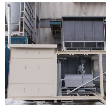
導入予定の農業残渣ボイラー
