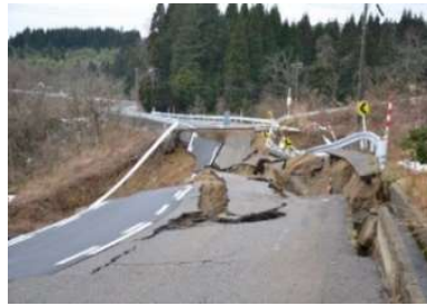
<地震により崩落した国道 359 号>
