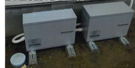
個人向け蓄電池設備
