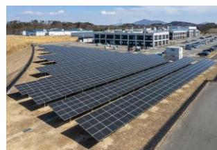
環境創造センターへの太陽光発電設備（自家消費型）の導入
