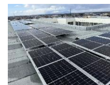
再エネ設備の導入
