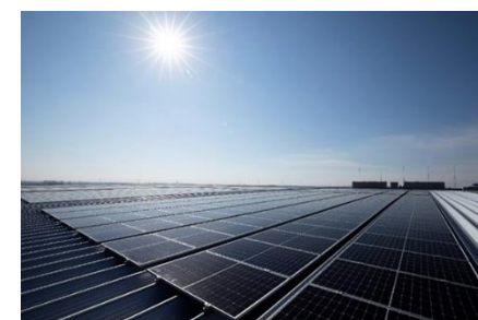
屋上太陽光パネル
