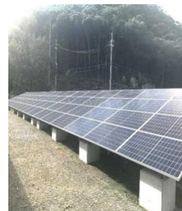
設置した太陽光パネル
