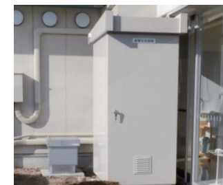
蓄電池 (駅東地域交流センター)
