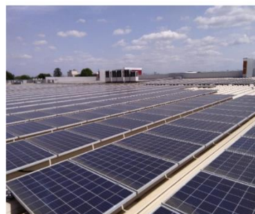
太陽光パネル
