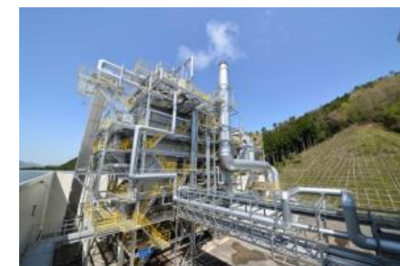
真庭バイオマス発電所
