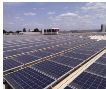
太陽光パネル
