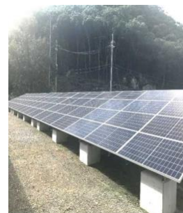
設置した太陽光パネル
