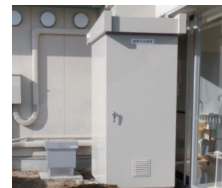
蓄電池 (駅東地域交流センター)
